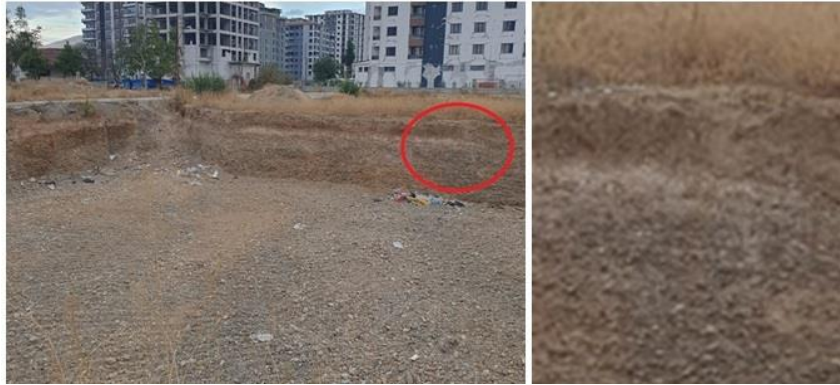
Görsel 7. Zemin problemleri
