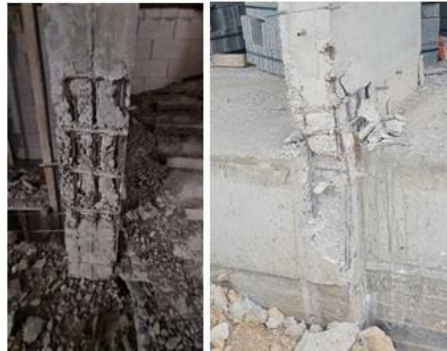
Görsel 2. Yetersiz perde duvar
