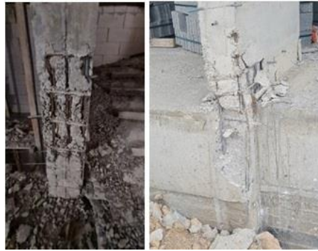
Görsel 2. Yetersiz perde duvar
