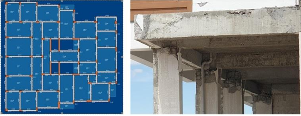
Görsel 1. Yetersiz perde duvar
