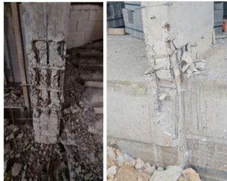
Görsel 2. Yetersiz perde duvar
